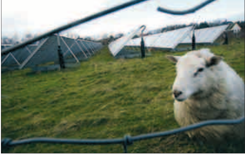
VÄRMANDE. Solfångarna vid ett av Samsøs fjärrvärmeverk är enkel och pålitlig teknik. Röjning av sly är nära nog det enda underhåll som behövs. Också det sköts nästan automatiskt.
